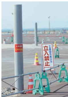
「火気厳禁」と注意書きが 貼られたガス抜き管
